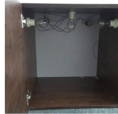
Figura 16. El circuito eléctrico y los focos instalados.
