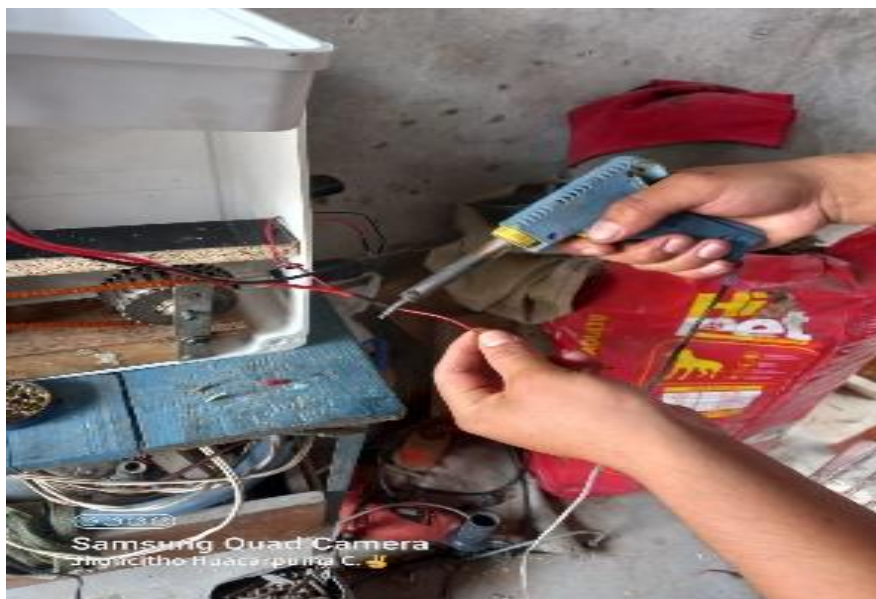
Instalación de sistema eléctrico del módulo probador de sensor CKP
