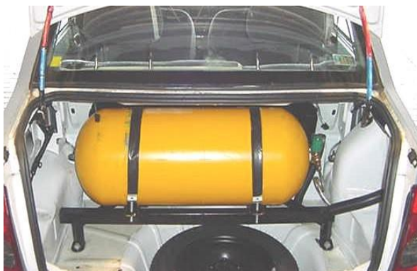
Figura 6. Cilindro de almacenamiento de GNV
