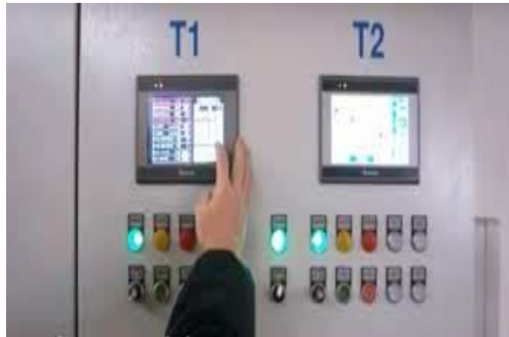
Figura 37. Controles de la máquina escarificadora
