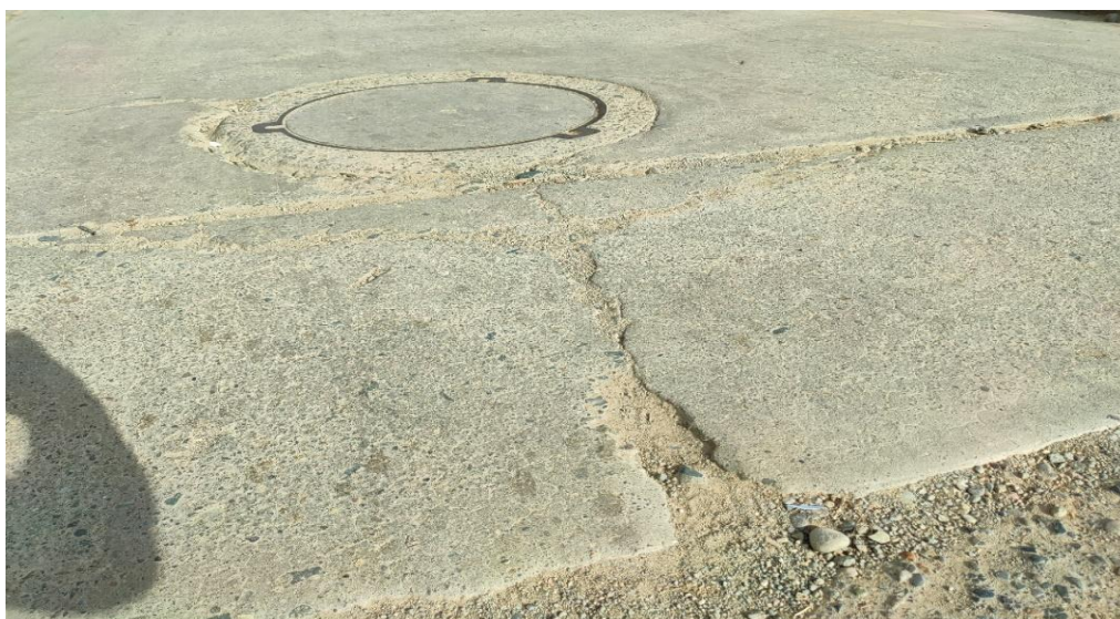
Figura 21: Poupouts y grietas con desprendimiento, cuadra 6.
