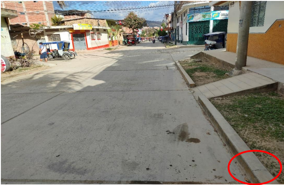
Figura 17: Fisura mapeada o grieta en sardinel de la cuadra 5.
