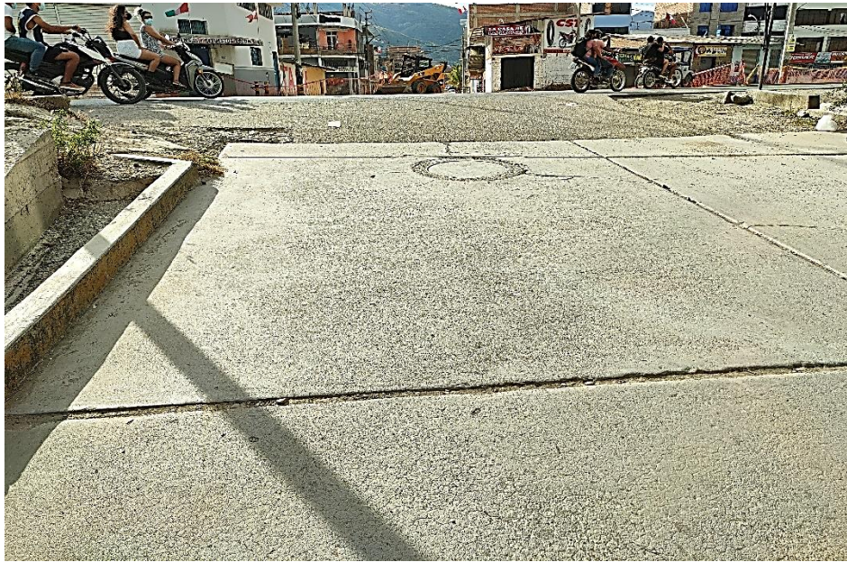
Figura 14: Descascaramiento, en la cuadra 4.
