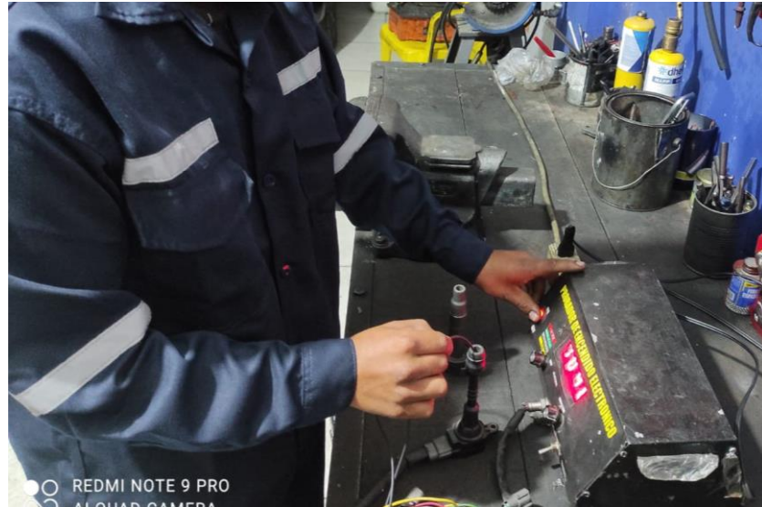
Figura 37. Interruptor de alimentación general del módulo
