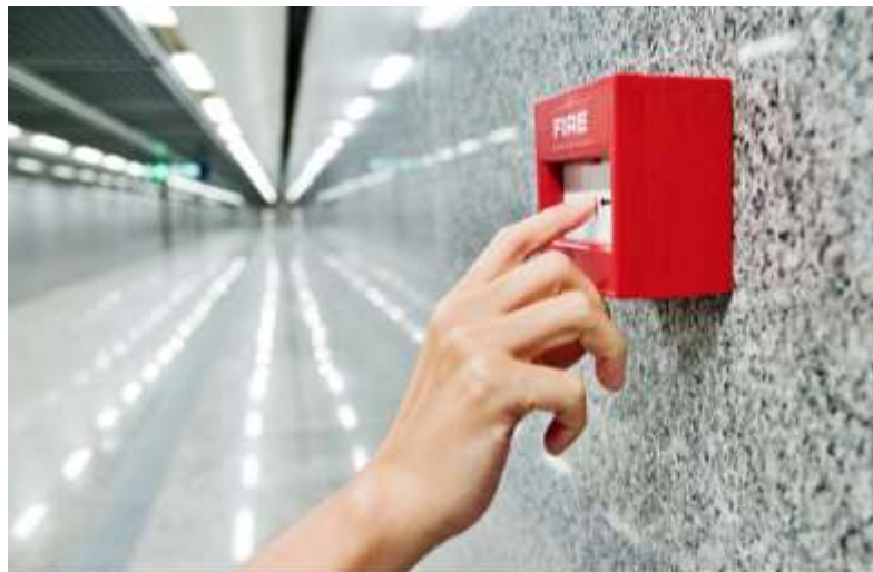
Figura 2. Accionamiento manual de alarma contra incendio. Tomado de Netatmo.com
