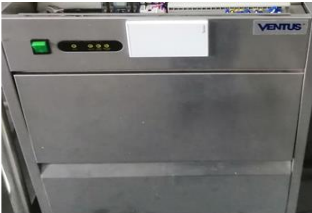
Figura 25. Se procedió a la instalación del Módulo de control de IOT en el tablero de control.
