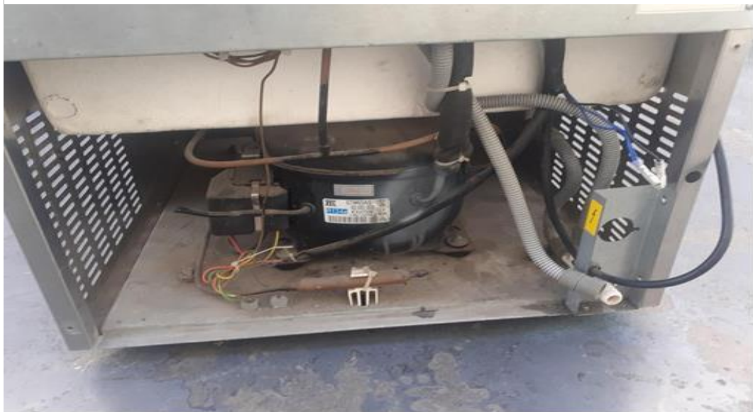
Figura 11. Reconocimiento electromecánico de la hielera VENTUS.
