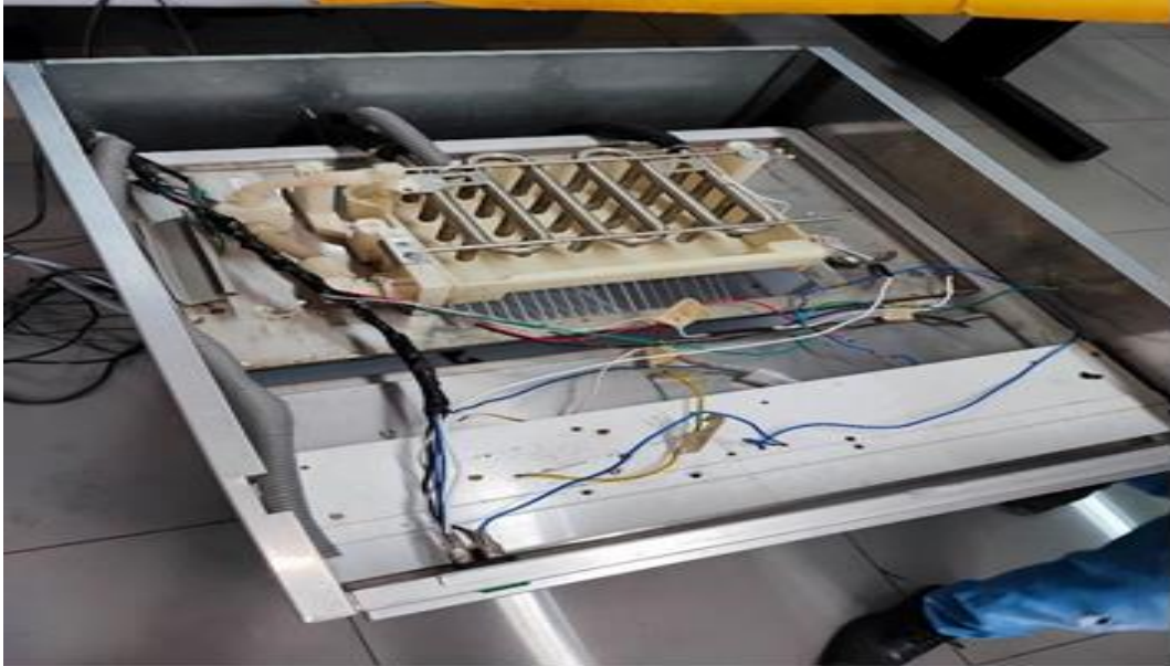
Figura 12. Cables identificados y marcados de la hielera VENTUS.
