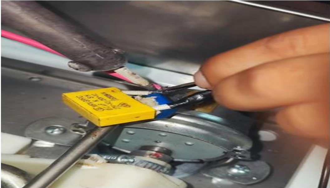
Figura 20. Se reforzó el condensador del motor reductor con estaño y se agregó un aislante.
