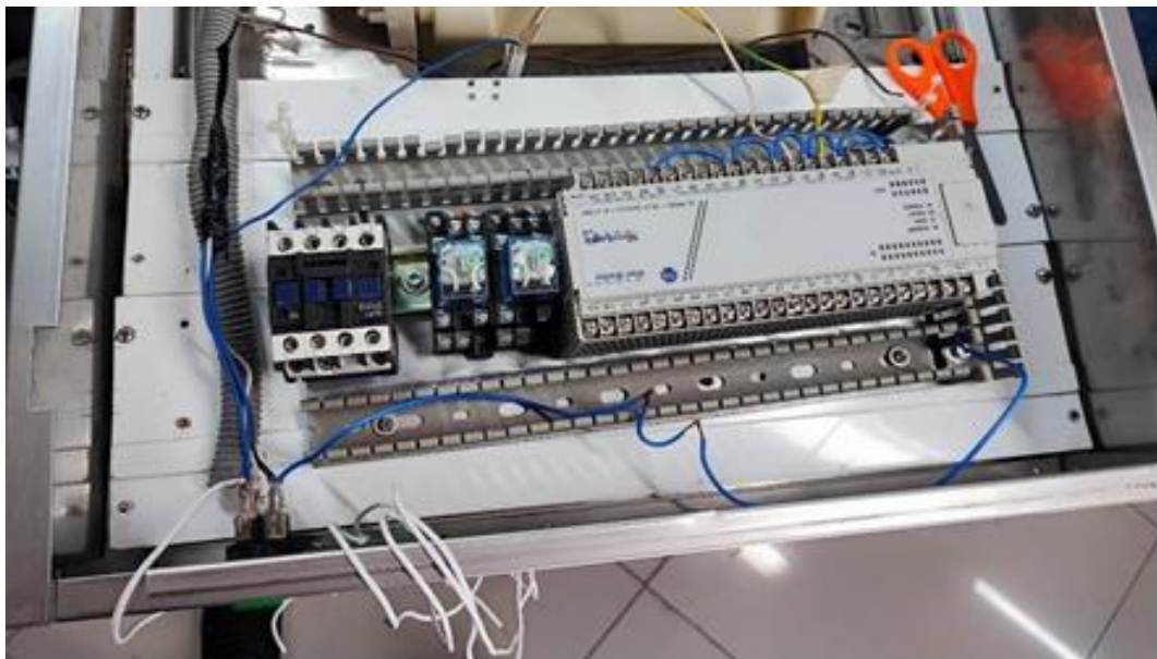
Figura 27. Se ofrecieron ideas y recomendaciones para asegurar la fijación adecuada del contactor, los relevadores y el PLC en el tablero de control de la hielera VENTUS.
